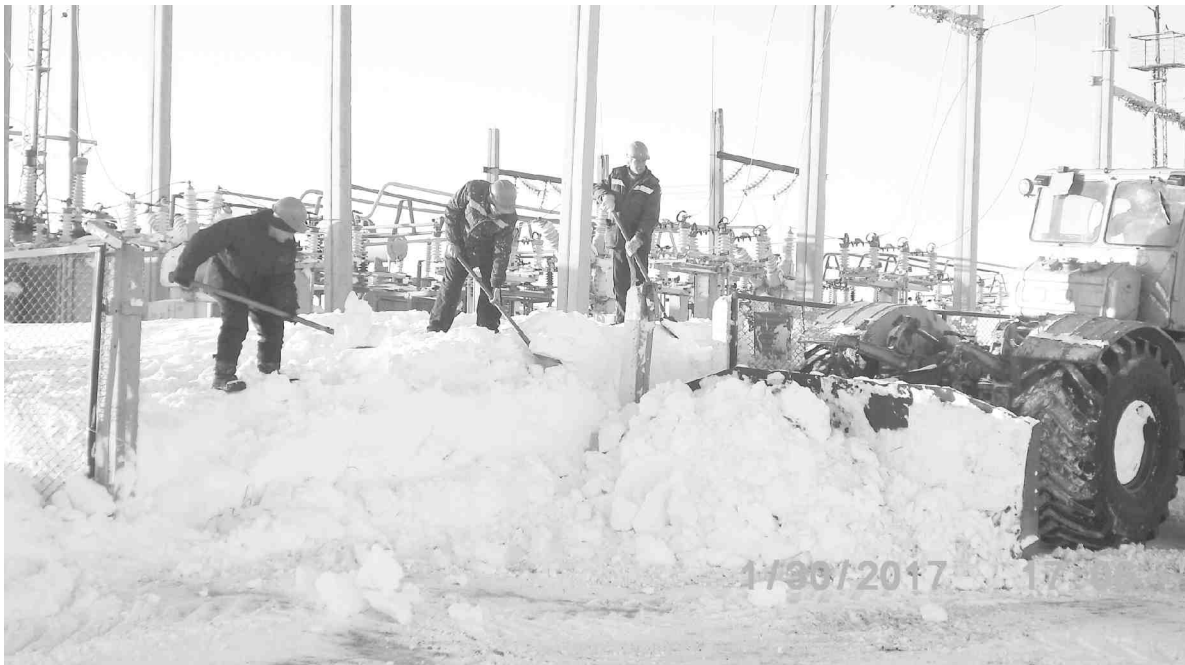
Будни Сандыктауских РЭС. Фото Сергея ПУСТОВАЛОВА.
